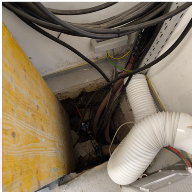
Obrázok 2: káblový prestup v NN rozvodni objektu.
